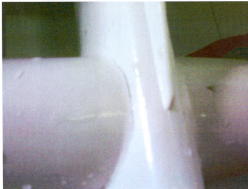
Punto di rottura / Crack point
